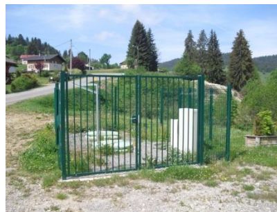
Poste de refoulement du Derasson.
